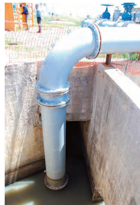
Condotta di captazione.
