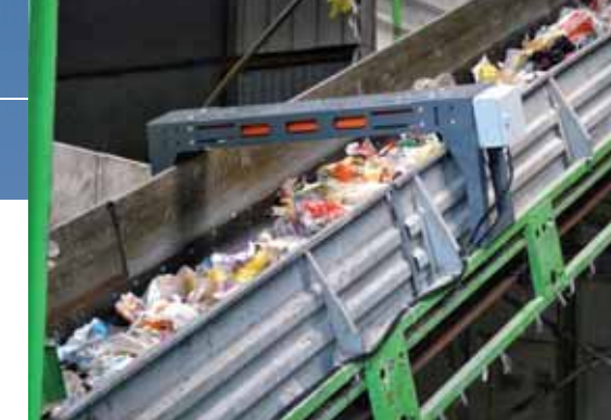
Sistema volumetrico in un impianto di trattamento rifiuti.
