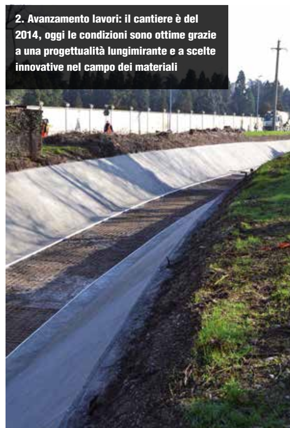
1. Riqualificazione del calcestruzzo di un importante canale lombardo in chiave di messa in sicurezza e durabilità
